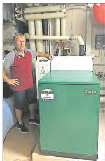
Norbert Merz aus Rheinfelden setzt auf Kraft-Wärme-Kopplung. SCHÄUBLE
